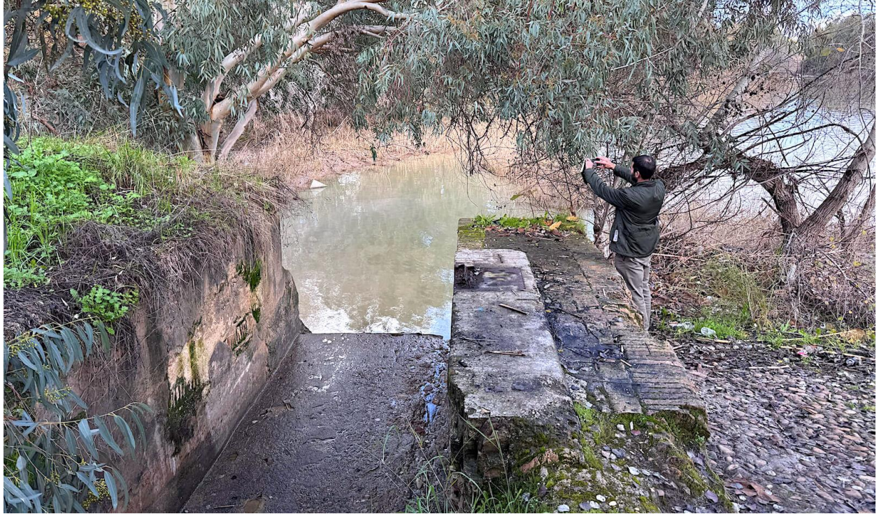
El ingeniero responsable del Proyecto de Obra Civil tomando notas y fotos del estado actual del Azud
